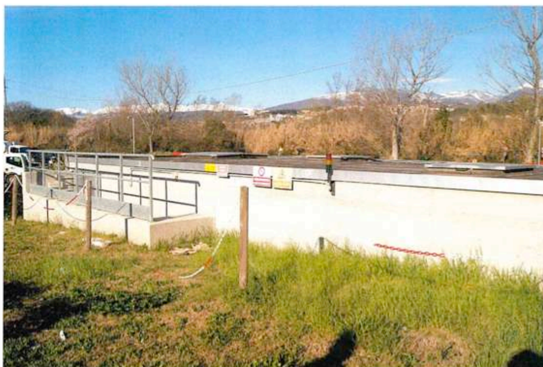
FOTO 29: Vista Locale pompe antincendio.
