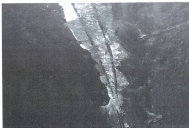
FOTO MACCHIE D'UMIDITA' CON DISTACCO IN CALOTTA E PIEDRITTI. Progr. m 10216 - calotta sx
